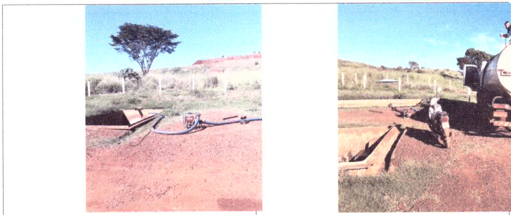
Foto: Armazenamento e retirada do chorume para encaminhamento a ERPAI 2019
