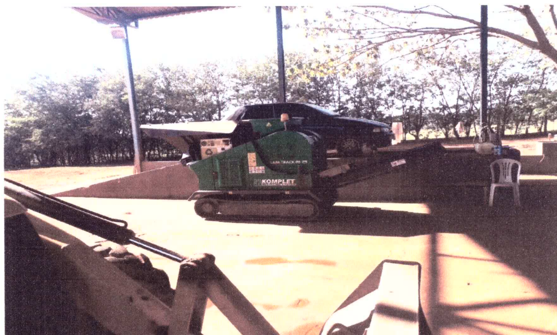
Foto: Galpão de máquinas h) Sistema de armazenamento do percolado (Chorume) com envio para a ERPAI:
