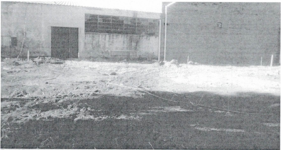
Foto: Vista área externa onde será colocado bloquetes, obras em fase inicial.
