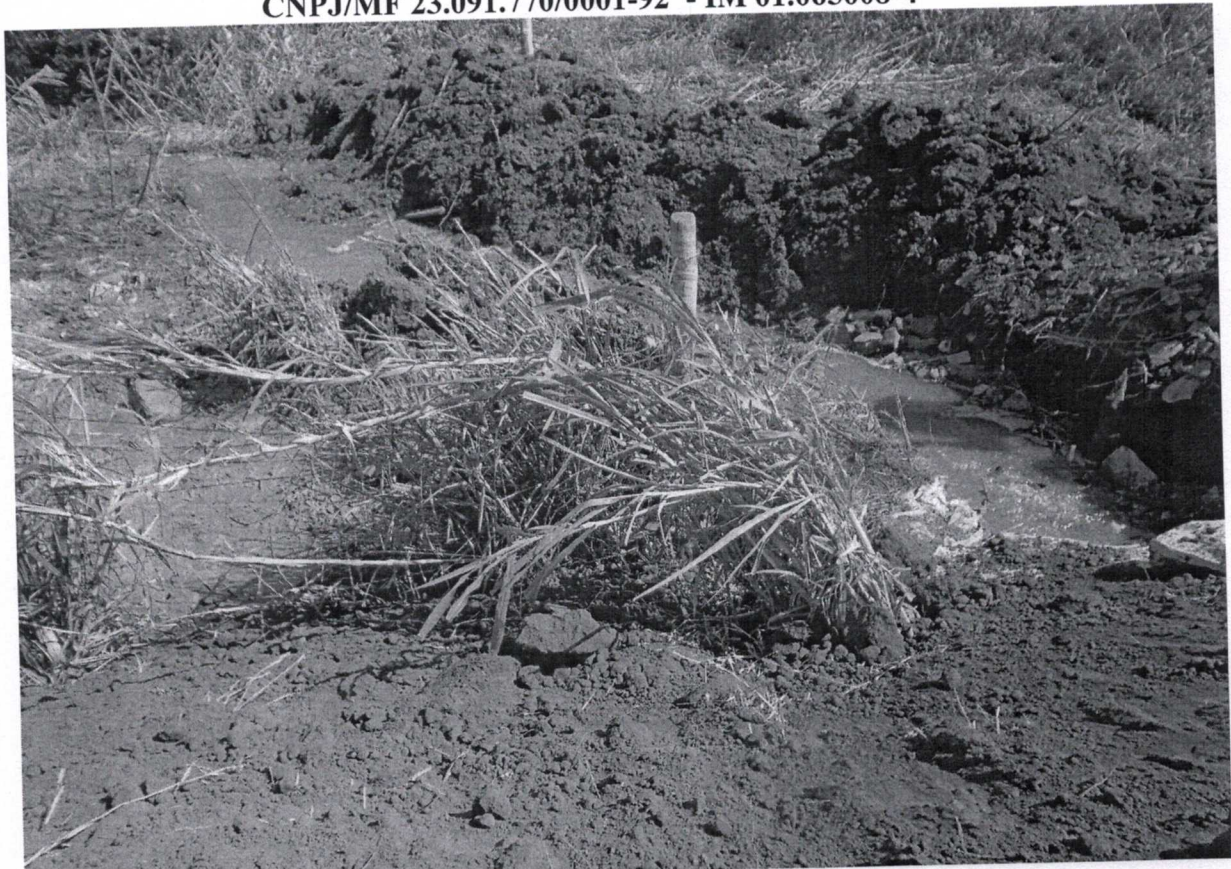
Foto 02: Panorama do vazamento das manilhas.
