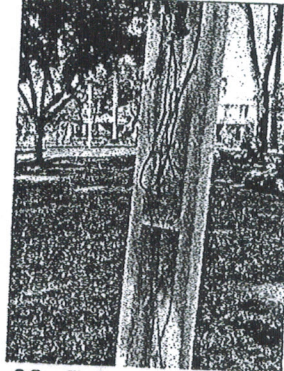
Foto 28: Cabos de ligação feita diretamente na rede
