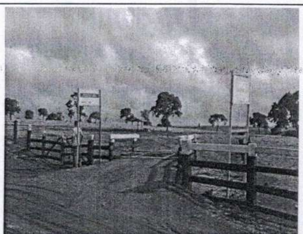
Foto 6: Empresa ARQGRAPH realizando serviços de instalação da Placa de Obra no imóvel rural.
