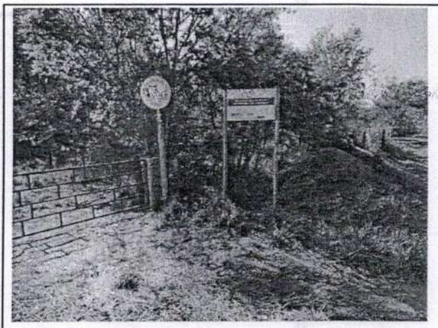
Foto 6: Empresa ARQGRAPH realizando serviços de instalação da Placa de Obra no imóvel rural.
